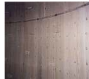
Revestimiento tacho de cocido
